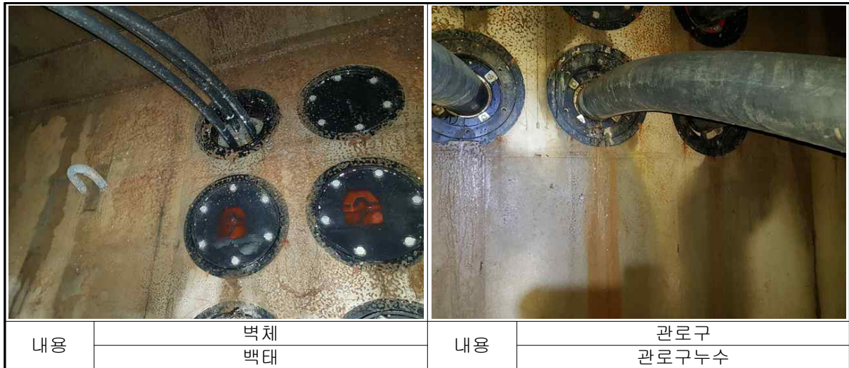
【사진 4.2】 맨홀 내부 주요 손상
