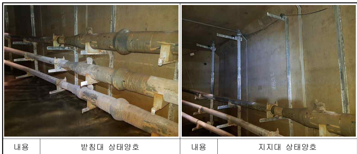
【사진 4.8】 부속 및 부대설비 현황
