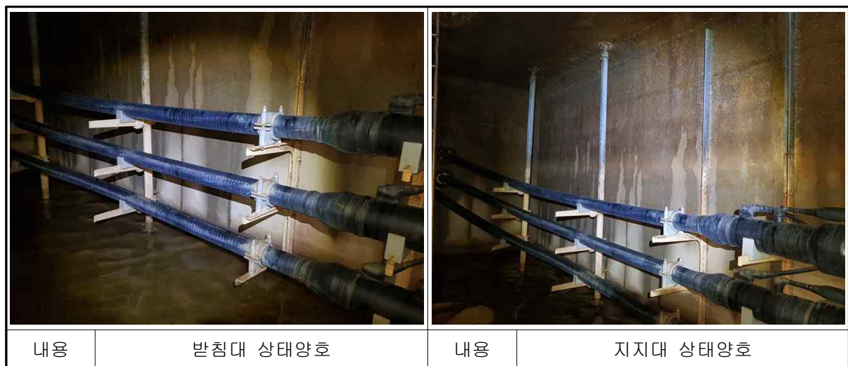
【사진 4.4】 부속 및 부대설비 현황
