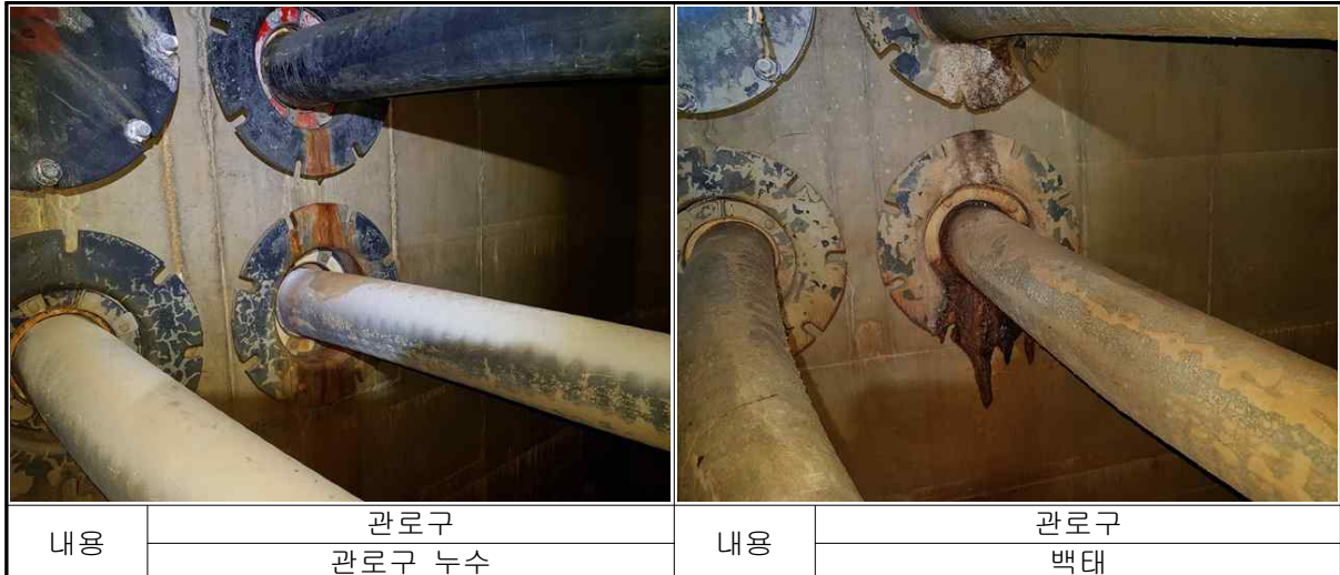
【사진 4.6】 맨홀 내부 주요 손상
